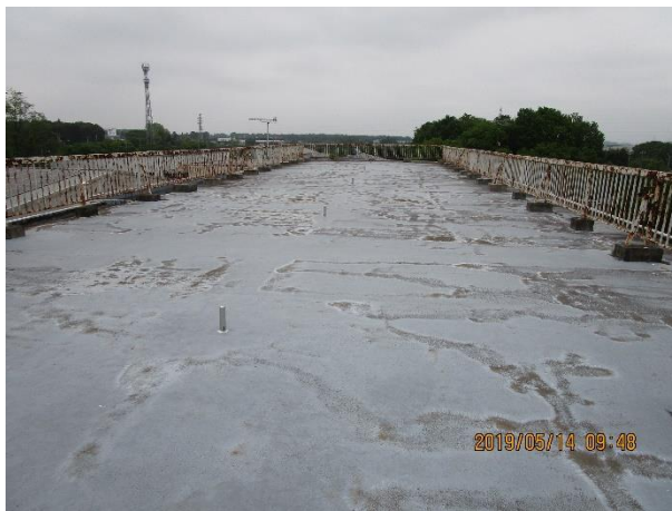
【薄葉小学校の校舎屋根防水劣化状況】
