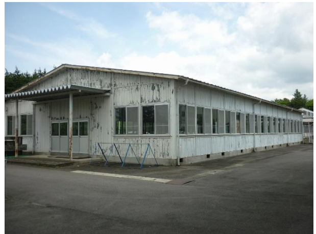
【湯津上中学校の武道館外壁劣化状況】
