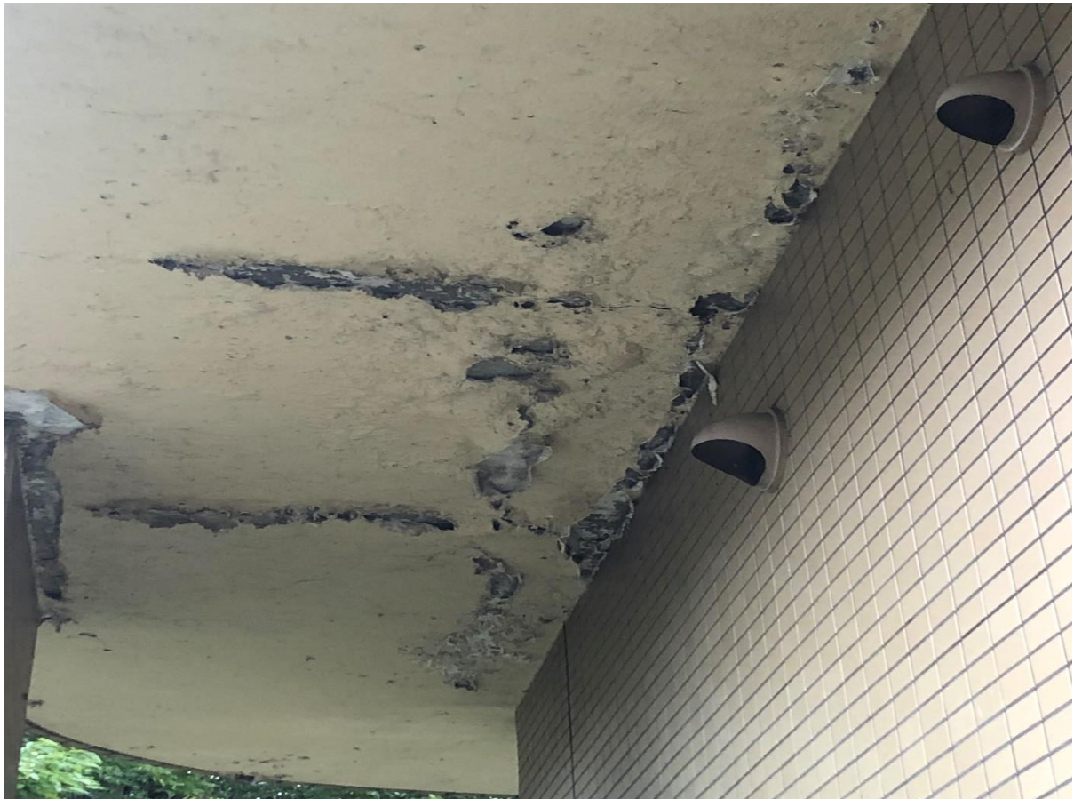
↓ 浸水による外壁塗装の劣化（ふれあいの丘 2 階外階段）
