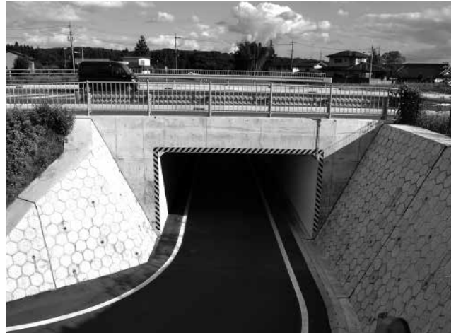
大雨時に冠水の恐れがある佐良土アンダー
