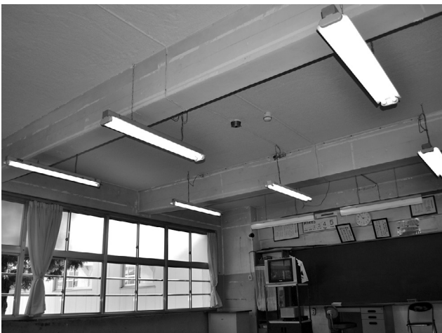
学校内の照明器具などの非構造部材の耐震化を図る必要があります
