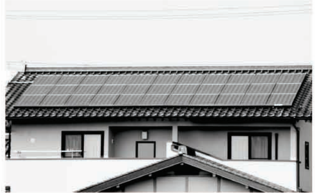
住宅に設置された太陽光発電システム
