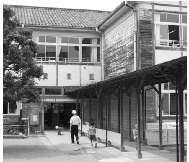
改修が望まれる大田原小学校木造校舎
