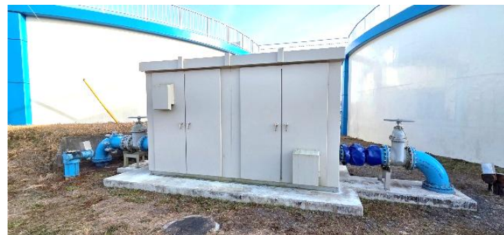
上石上発電所 (株DK-Power所有)
