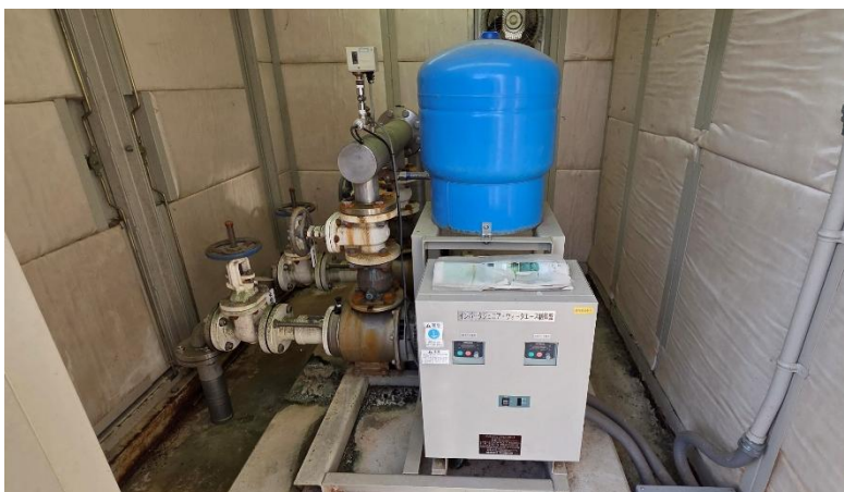
老朽化が進む場内加圧ポンプ(H17設置)
