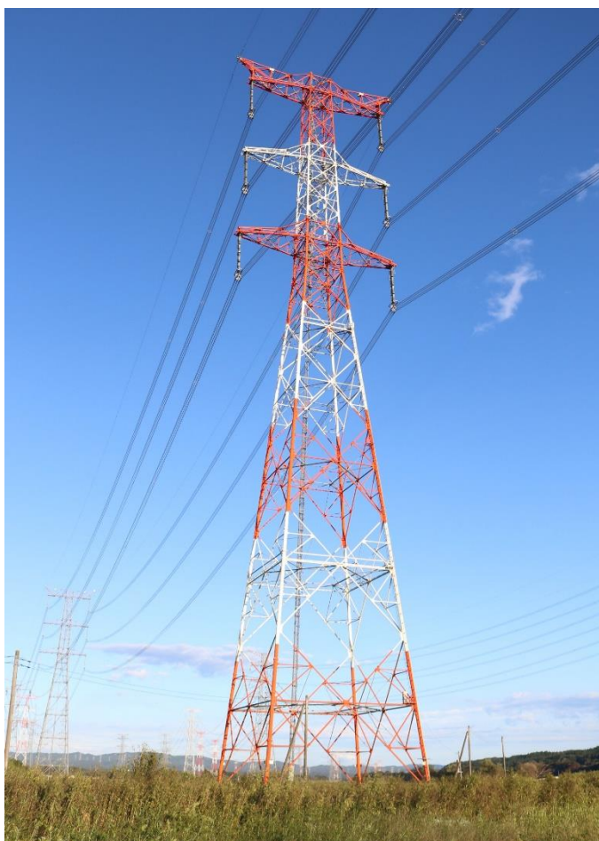
▲南いわき幹線 184 号鉄塔
