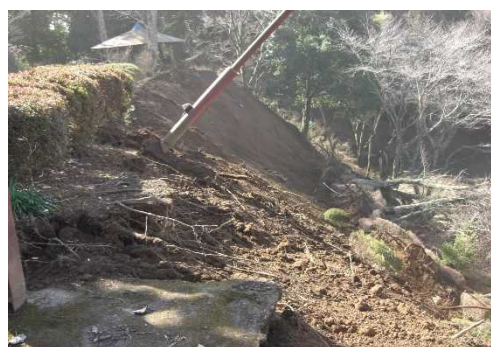
東日本大震災により崩れた法面
