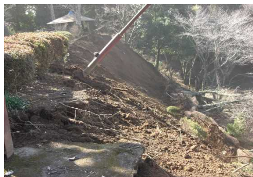
東日本大震災により崩れた法面
