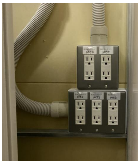
本庁舎 ４階東側E P S内
