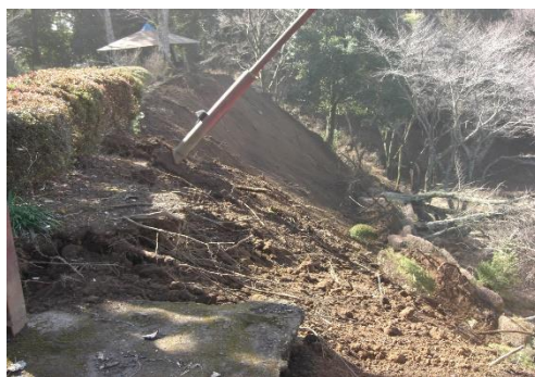
東日本大震災により崩れた法面
