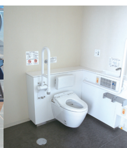
オストメイト対応 多目的トイレ（1階） ベビーベッド・ベビーチェア・音声誘導 ・呼出機能・フラッシュ機能あり
