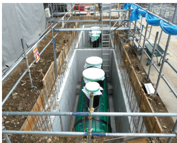
設置した2基のオイルタンク
