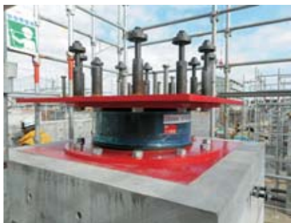
設置された免震装置
