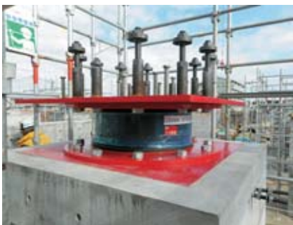
設置された免震装置
