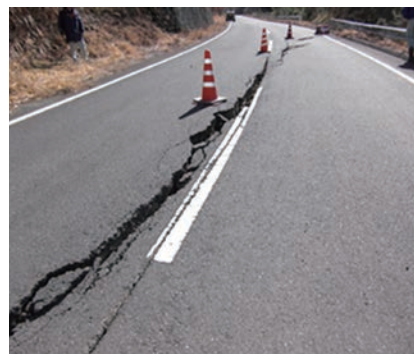
林道の地割れ
