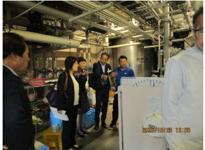
屋内温水プール 改修したボイラー室についての説明
