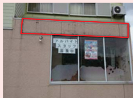
落下した後の壁面
