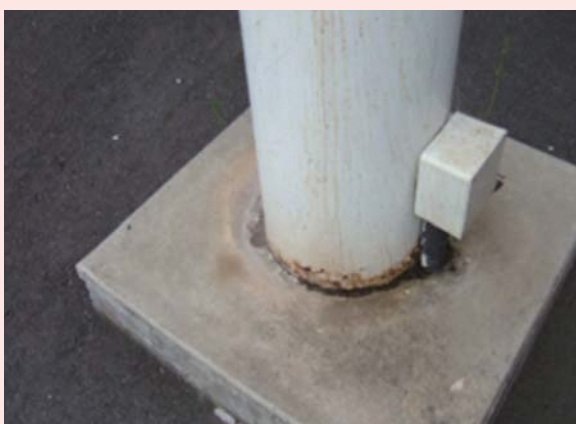
ポールの根元にサビが発生
