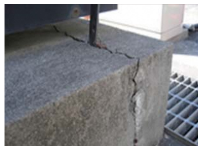
看板基礎のひび割れ
