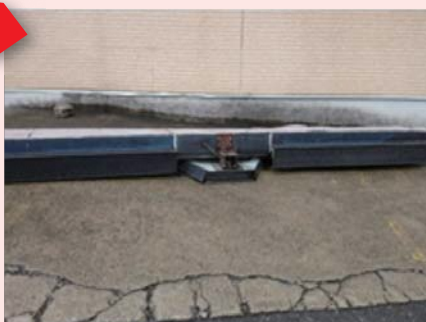
落下した欄間看板
