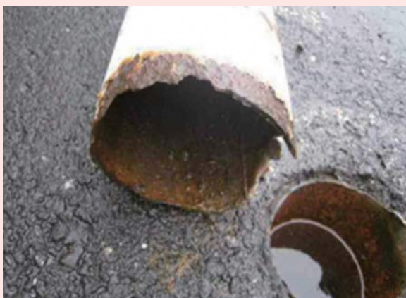
ポールの根腐れによる倒壊
