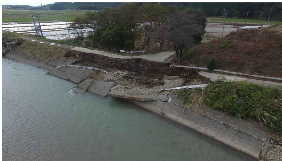
令和元年の東日本台風（台風第19号）による被害
